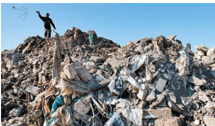
ภาพที่ 2-3 เศษวัสดุเป็นขยะของเสียจากการก่อสร้าง และรื้อถอนอาคาร
